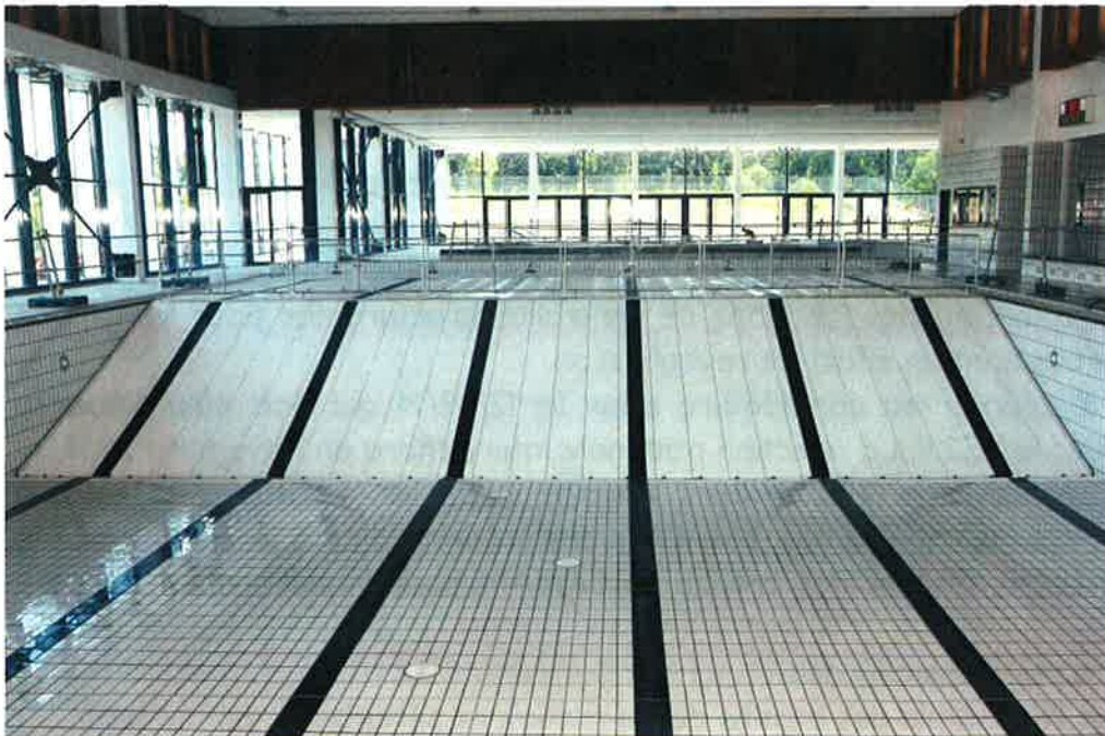
Bassin vide et plancher amovible au plus haut. Le plan incliné et le tablier empêchant l'accès aux vérins.
